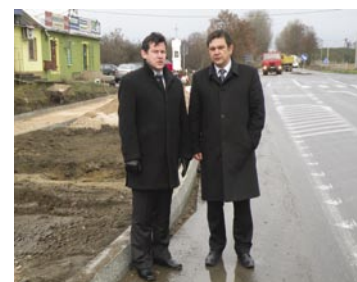
Członek Zarządu Woj. Mazowieckiego Piotr Szprendałowicz i Starosta Andrzej Oziębło na budowanym rondzie w Falęcicach.
