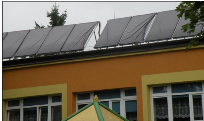
Solary na budynkach przykryte plandekami. "Słoneczna energia dla gminy" - pieniądze wyrzucone w błoto.
