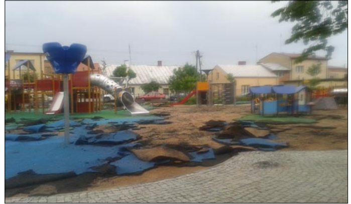
Plac zabaw co roku jest zamykany z powodu kolejnych remontów.
